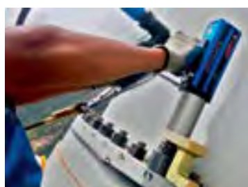
Serrage sur éolienne avec une E-RAD BLU 3400C
